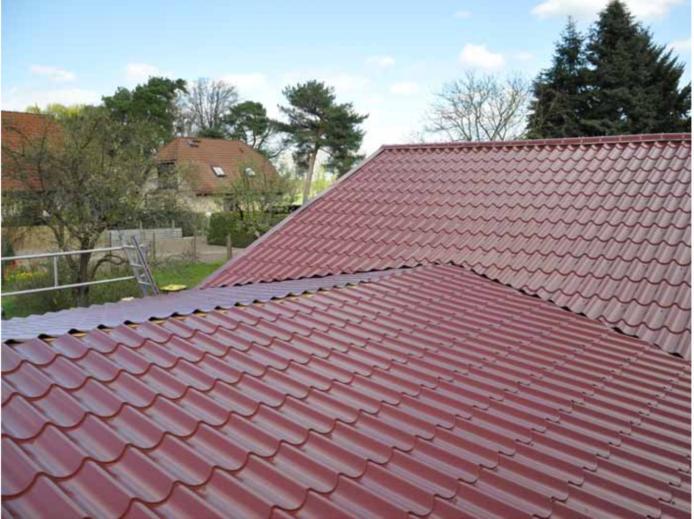
BU: Geringes Gewicht, leichte Verarbeitung und optisch attraktiver Look. Metalldachpfannen von Luxmetall eignen sich optimal für die Sanierung alter Dächer. Den Abschluss bildet die Firstabdeckung, die hier noch nicht montiert wurde. Bild: tdx/Luxmetall
